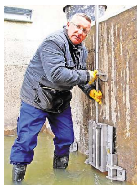
Jörg Pöhlitz bei Montagearbeiten an einem der drei neuen Schieber an der Wehrschwelle.
